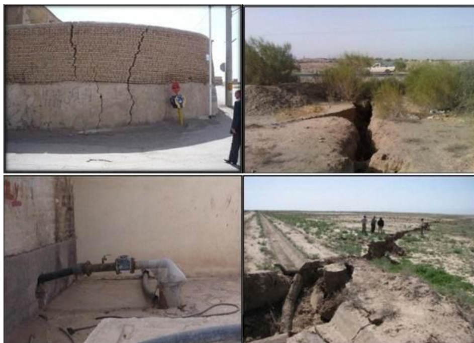
شکل (۱۶) نمایی از فرونشست در دشت کاشان
