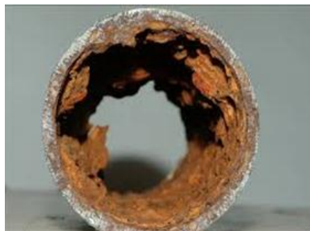
تصویر (۱) خوردگی لوله بر اثر اسیدیته آب
